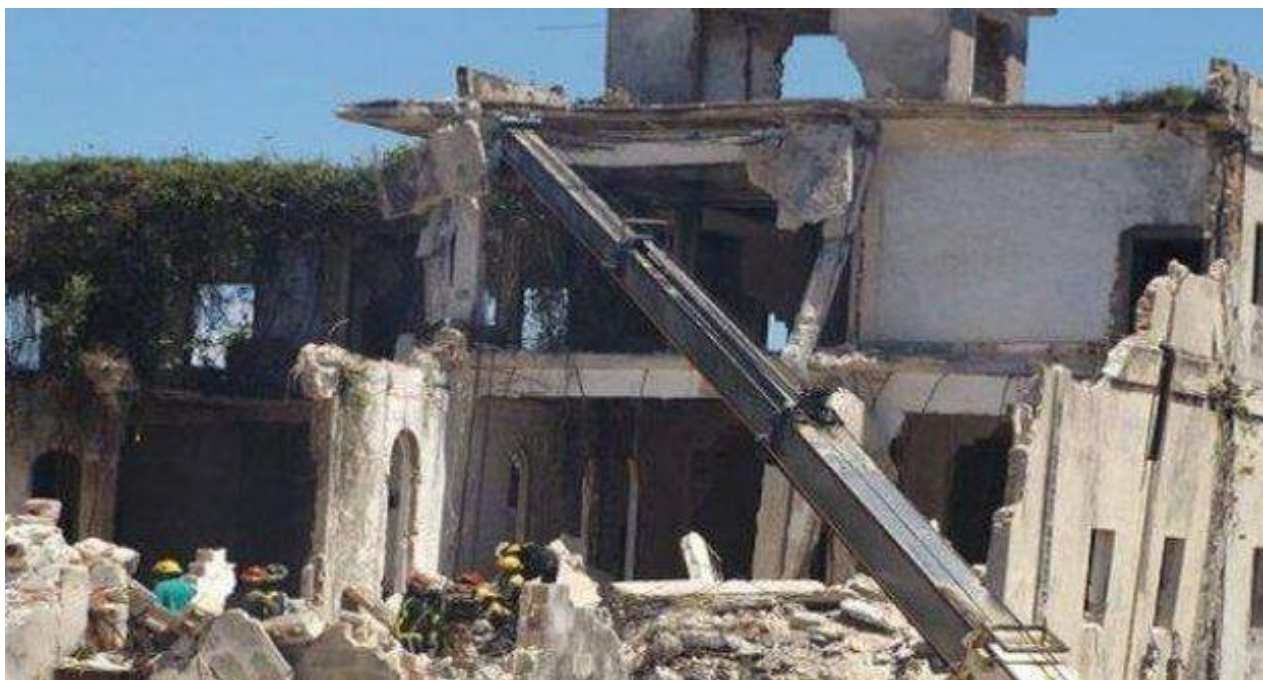
Hotel Comercio en Caibarién, en cuya reconstrucción perecieron dos obreros. (Radio Caibarién)
