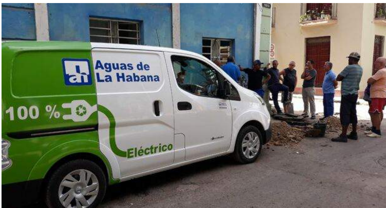
Reparaciones en las tuberías de agua en la calle Picota, en San Isidro, La Habana Vieja. (14ymedio)
