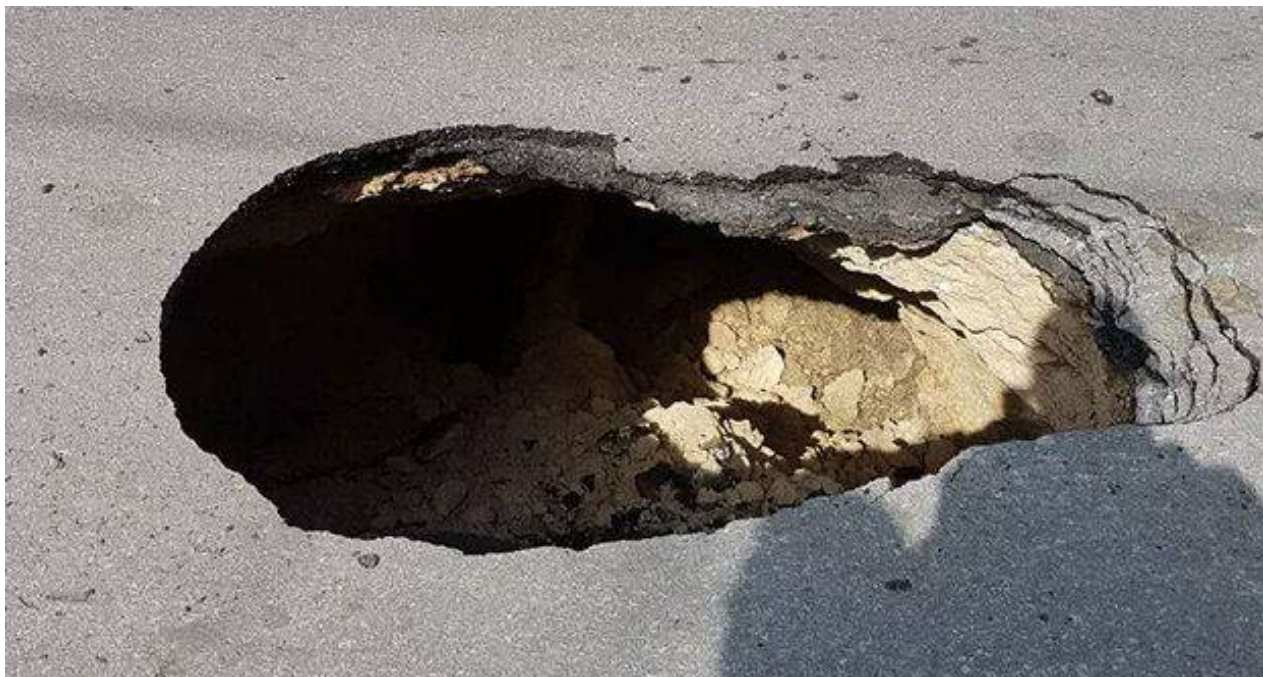
Fotografía del hueco en el puente sobre el arroyo El Inglés, en Cienfuegos. (14ymedio)
