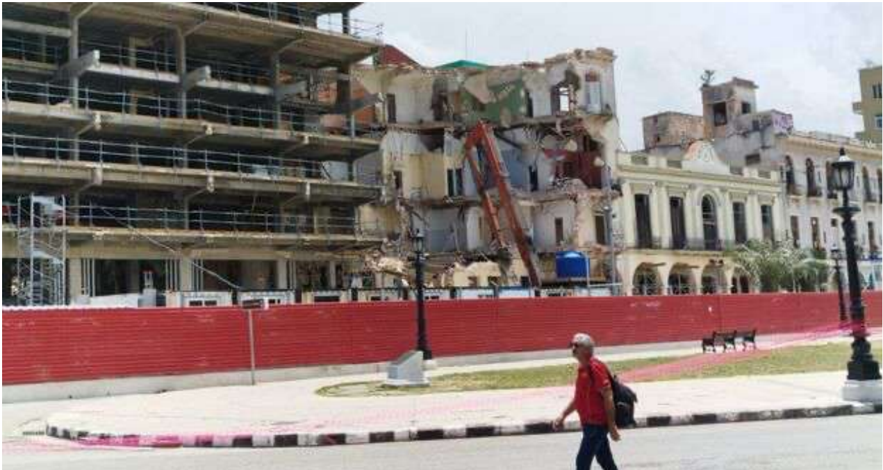
La explosión del hotel Saratoga, el 6 de mayo de 2022, dañó varias edificaciones a su alrededor. (14ymedio)
