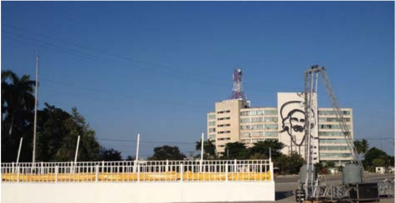
Obras para edificar el altar para el papa en la Plaza de la Revolución de La Habana. (Foto Luz Escobar)
