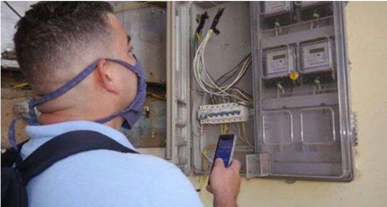
Un trabajador de la Empresa Eléctrica revisa los metro contadores de un edificio. (Tv Avileña)
